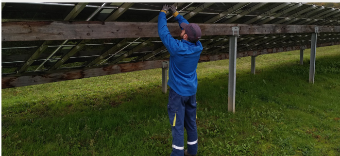
Maintenance de la centrale solaire de Massangis (89)
