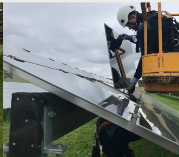
Antenne O&M de Massangis (89)
